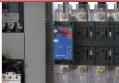
Main switch (above) and circuit breaker (inside cabinet) Hauptschalter mit Hauptsicherung
